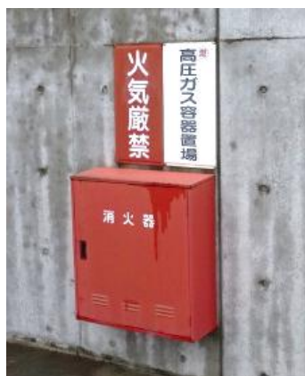
図7-3 消火器格納ケースと消火器の表示
