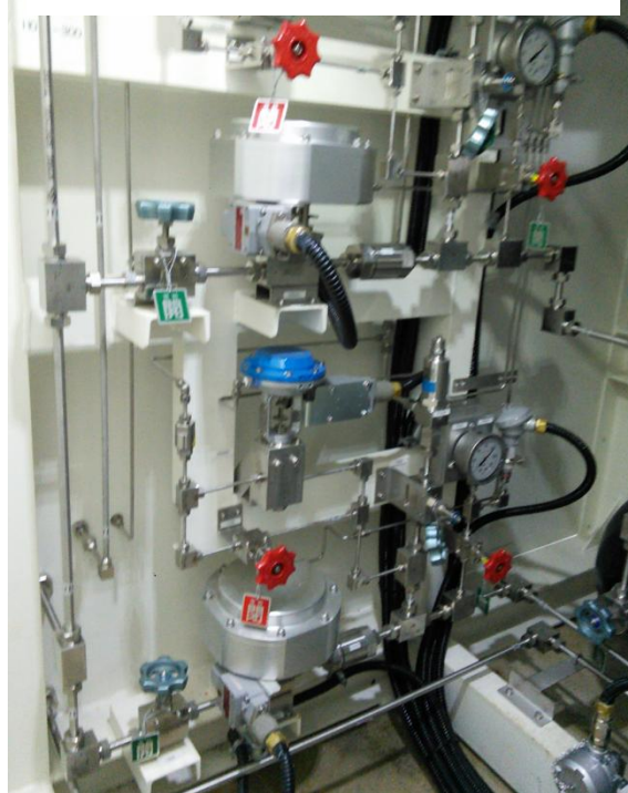
機械式継手が多用された組配管
