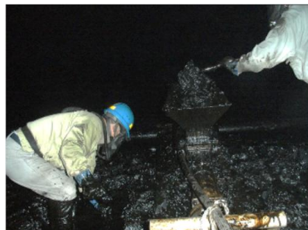
タンクでのスラッジ堆積
