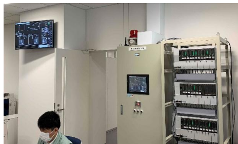
ガス設備監視盤 (データ解析室・監視室)
