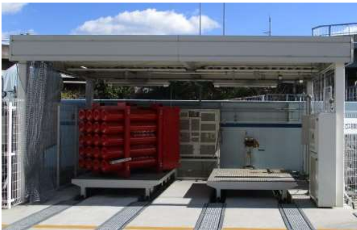
水素スタンドに併設された水素出荷設備の例
