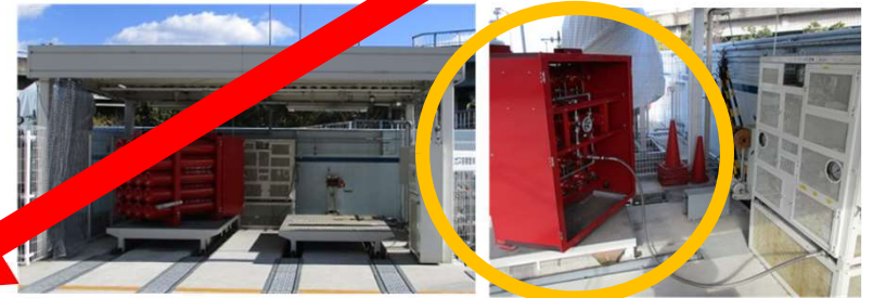
水素スタンドに併設された水素出荷設備の例
