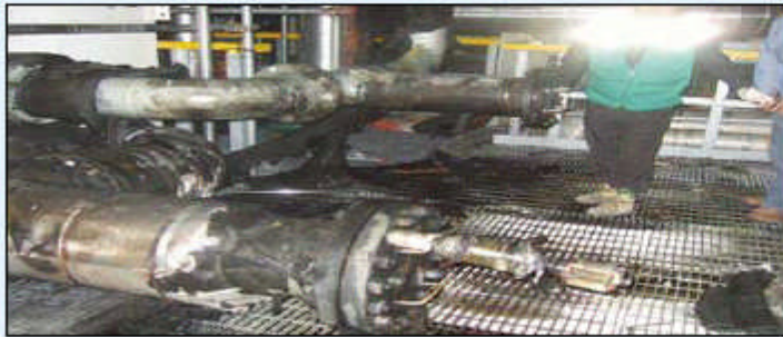
<火災当時Strainerの電動工具が付着された様子（左）とStrainer（右）の様子>
