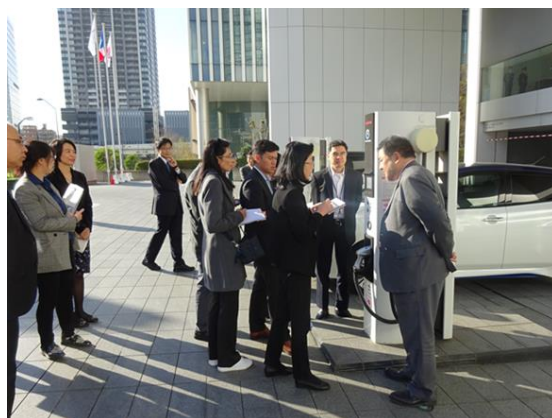
日産グローバル本社の EV 充電ステーション
